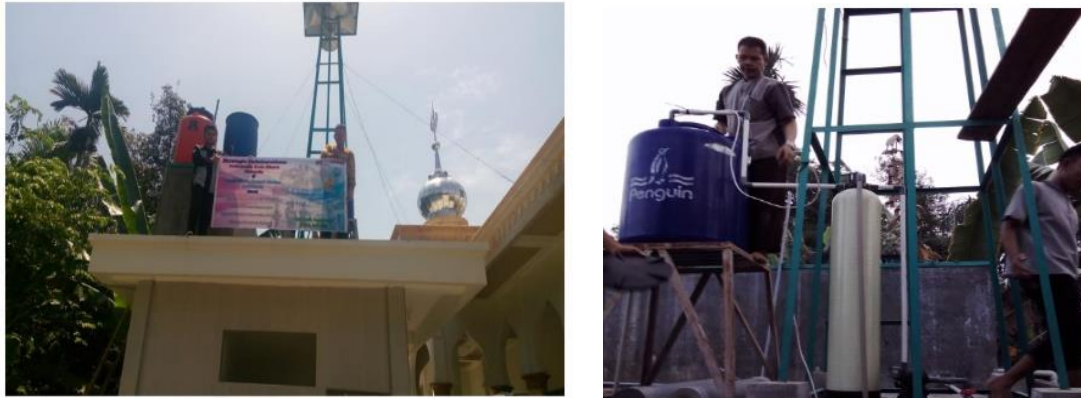
Gambar 1. Instalasi Penyaringan Air Terpasang
