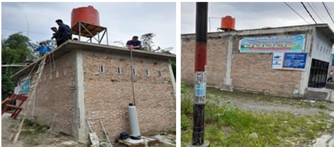
Gambar 1. Instalasi Penyaringan Air Terpasang
