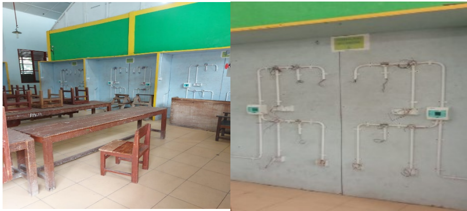
Gambar 2. Foto dokumentasi bengkel instalasi listrik SMK Negeri 2 Medan
